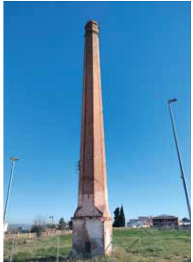
4. PIQUERAS Y MARÍN: Chimenea de la fábrica Piqueras y Marín, único vestigio conservado de la factoría textil.
